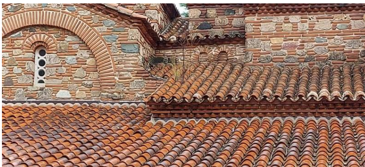
Протекување на атмосферска вода на кровот од од Западната црква
